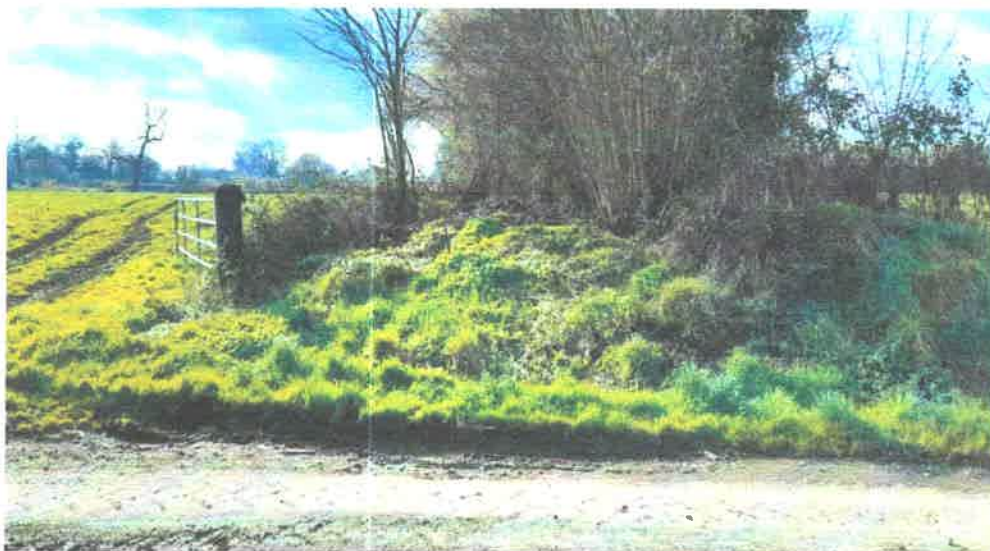
Entrée du chemin rural n° 8 impraticable (voir dépliant photographique détaillé)
